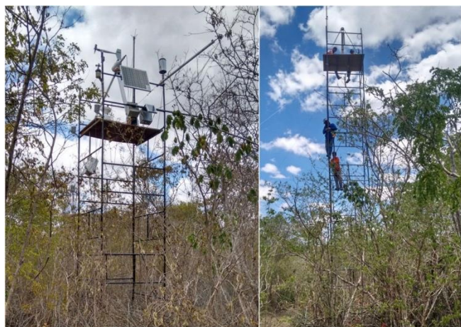
Figura 1. Torres onde estão instalados os sensores LAS (Fazenda experimental do INSA em Campina Grande-PB).
