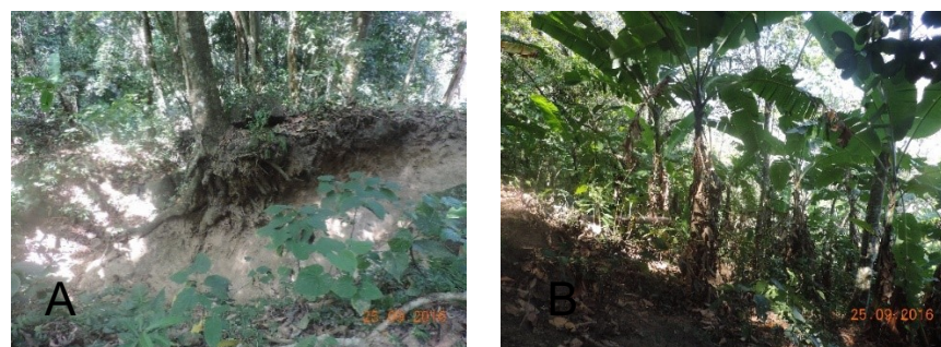
Figura 07 – (A) Exposição de raízes de árvore a partir da erosão; (B) bananeiras na vertente da serra.
